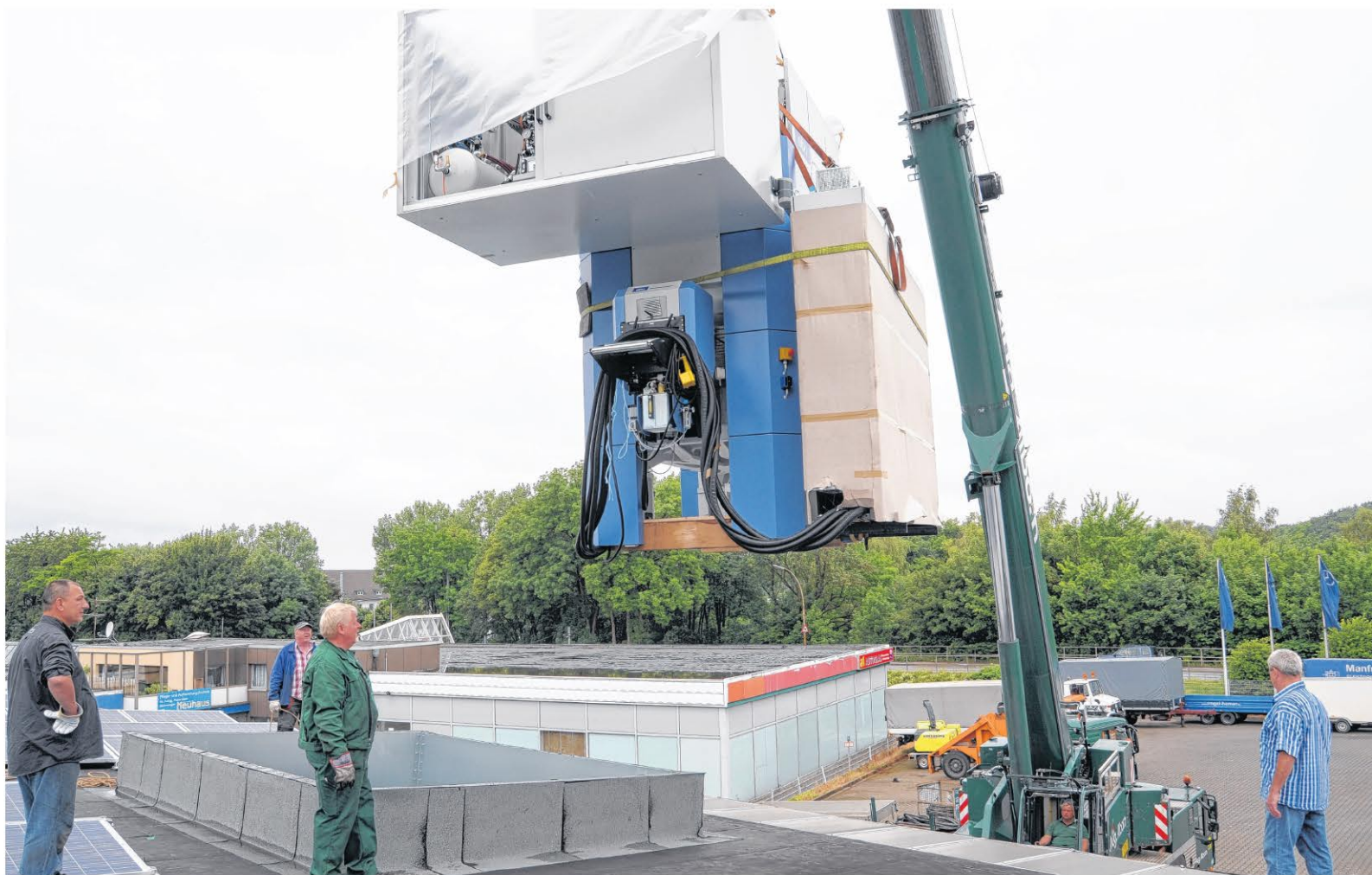
26 Tonnen am Haken: Am Mittwochmorgen wurde bei der Firma LAS in Iserlohn eine neue Stanzmaschine angeliefert, für die eigens das Dach einer Werkshalle geöffnet werden musste. Die Arbeiten dauerten bis zum Mittag an, in zwei oder drei Tagen soll die Maschine in Betrieb gehen.
